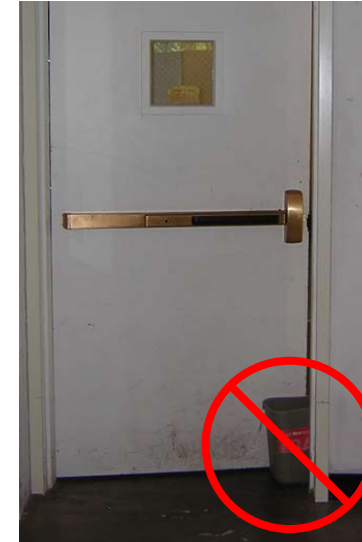
Door prop NOT OK
